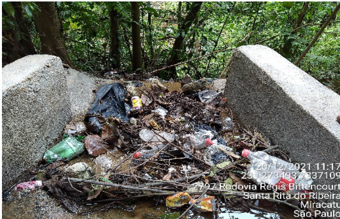
Figura 3 - Resíduos obstruindo sistema de drenagem
