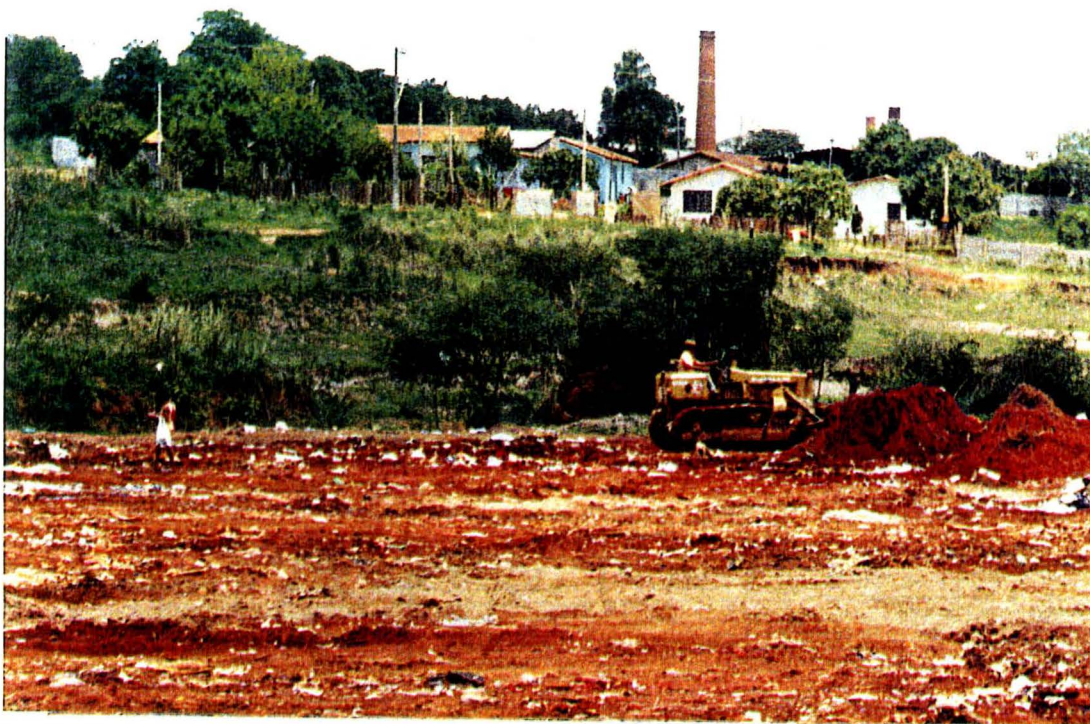
Foto 5 - Aterro controlado - "lixão"
