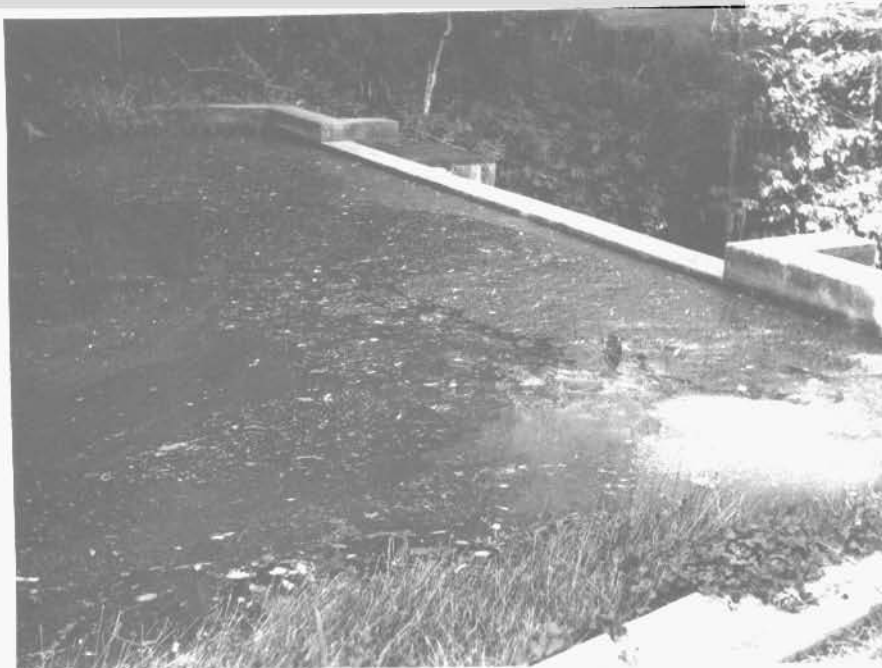
Estação de tratamento de água - Aluminio
