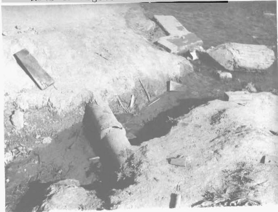
Rede de esgoto avariada
