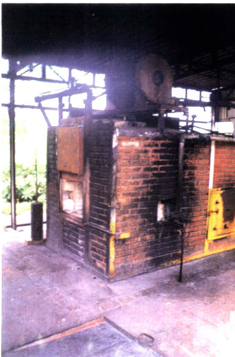
F20. Forno utilizado para incineração do lixo hospitalar.
