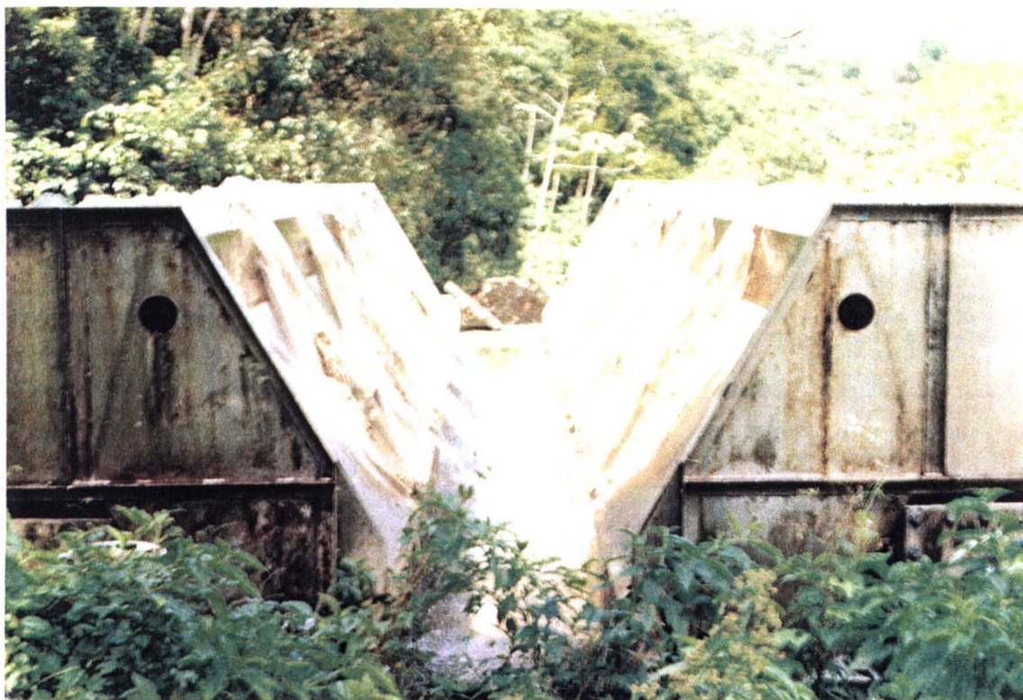
FOTO 17 DETALHE DO FILTRO COM FENEIRAS EM AÇO, JUNTO A CAPTAÇÃO DO RIO JURUBATUBA. (COTA 75)
