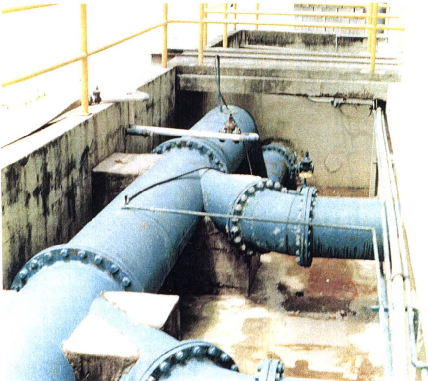
FOTO 19 - CHEGADA DA ADUTORA DE ÁGUA TRATADA
