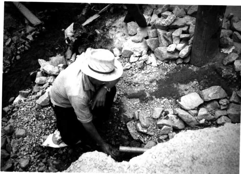
Bica contaminada e presença de esgoto a céu aberto
